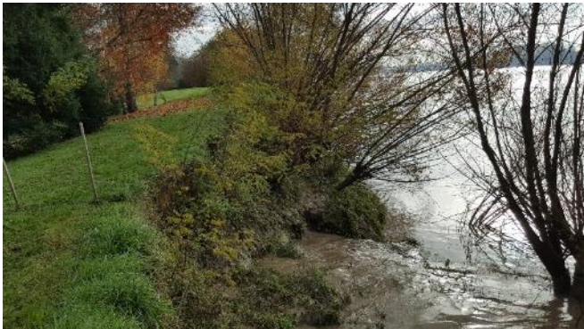
Digue menacée par l'érosion fluviale à Lugon
